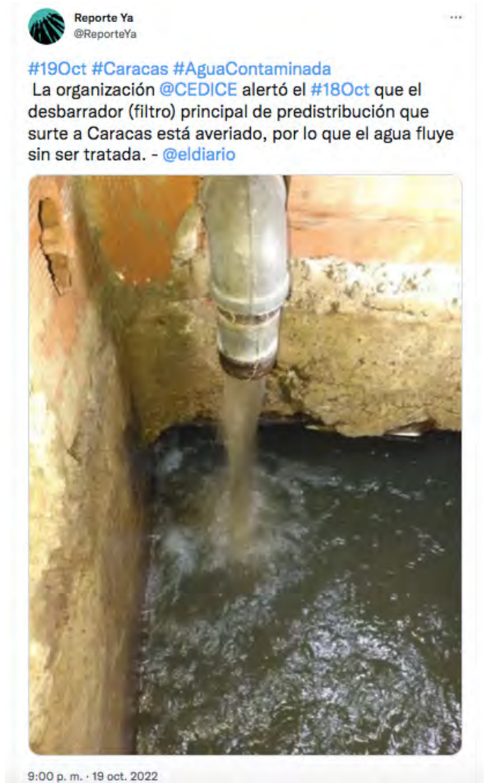
Figura 69. Avería de desbarrador de agua que surte a Caracas. Fuente: Reporte Ya @ReporteYa (2022)
